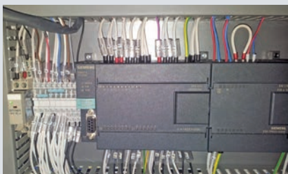
Quadro di controllo SIEMENS SIEMENS control panel
